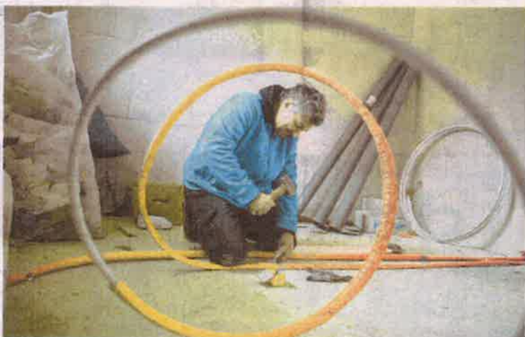
Dirk Fittinghof, Meister für Sanitär und Technik, verlegt Wasserleitungen. Damit das auch ordentlich wird, fixiert er die Leitungen im Betonboden.
